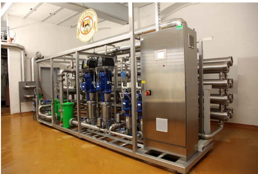
Umkehrosmose-Anlage mit frequenzgeregelten Lowara-Pumpen bei der Brauerei Gold Ochsen zur Brauwasseraufbereitung mit einer Leistung von 50 m 3 /h.
